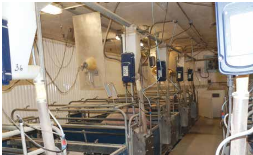
Le système Gestal fait partie des équipements dont dispose notre éleveur pour optimiser l'alimentation.
